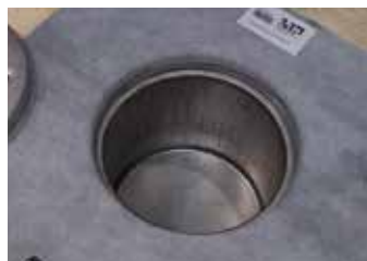
9. Brunnen är installerad med tätskikt och klämring.
